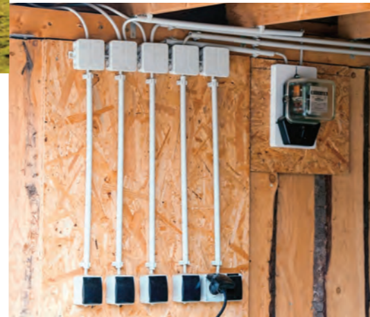
Ein automatischer Netzfreischalter, auch Feldfreischalter oder Netzabkoppler genannt, ist eine praktische Lösung, um unnötige elektrische Felder zu vermeiden.
